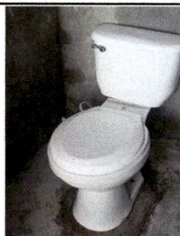
Foto 5: Sustrucción de inodoro
